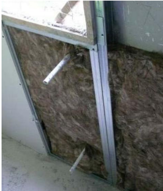
Interrupción del aislamiento por instalaciones
