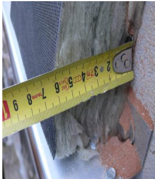
Ejecución incorrecta del aislamiento
